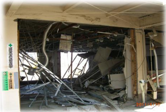
図-2 被災した(株)丸本組本社
