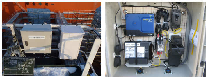
【コンクリート養生温度遠隔監視制御盤 内部状況】
